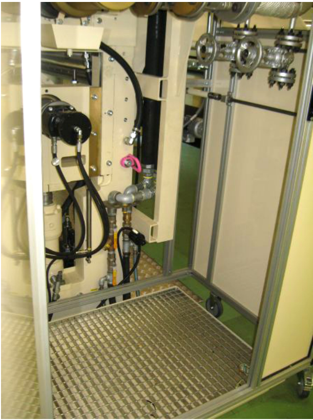
Innenbereich mit Auffangwanne
